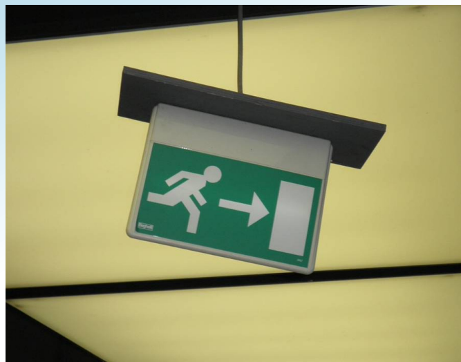
Foutief aangesloten armatuur
