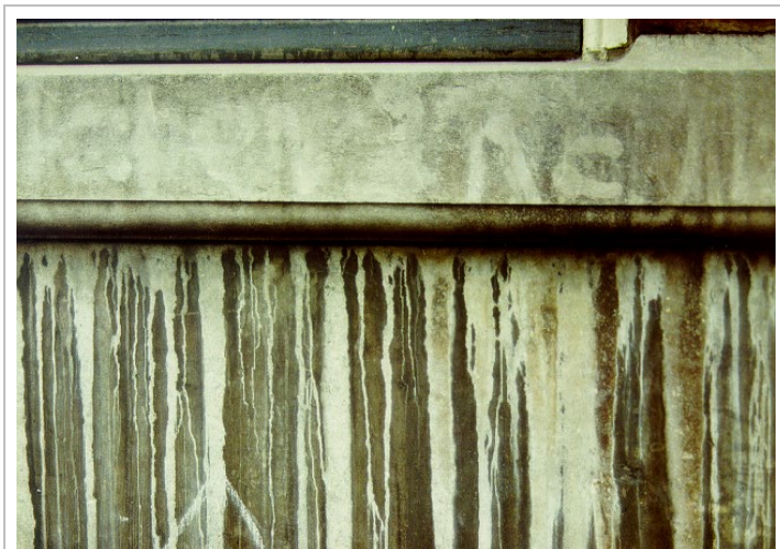
Figuur 12: Bij het verwijderen van graffiti zijn dunvloeibare middelen gebruikt zonder het onderliggende materiaal af te schermen.
