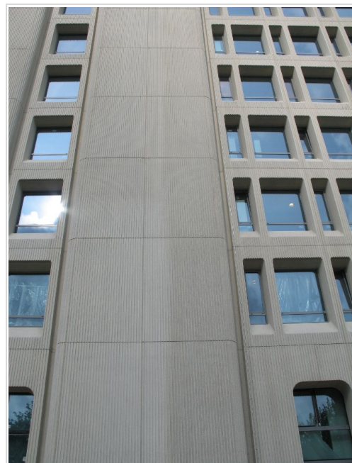
Figuur 13: Tintverschillen door verschillende inwerktijden met zure reiniging op betonnen gevel. Foto Yves Vanhellmont (WTCB)
