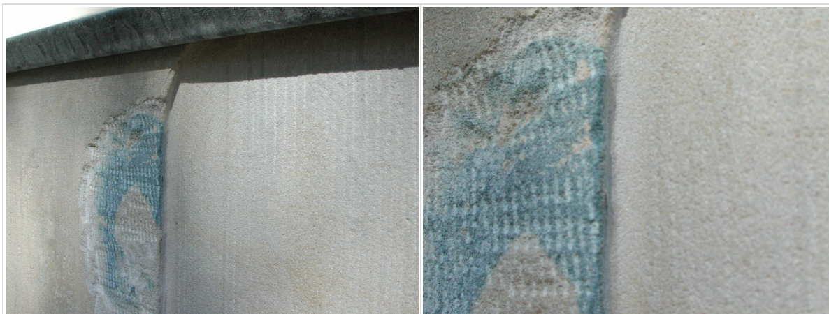
Figuur 6: Verf is zo diep in de zandsteen gedrongen dat deze niet meer zonder schade is te verwijderen. De bekladding is verwijderd door mechanisch een laag van de steen te verwijderen. Overschilderd was ook een optie geweest. Foto: M. Stappers (RCE)
