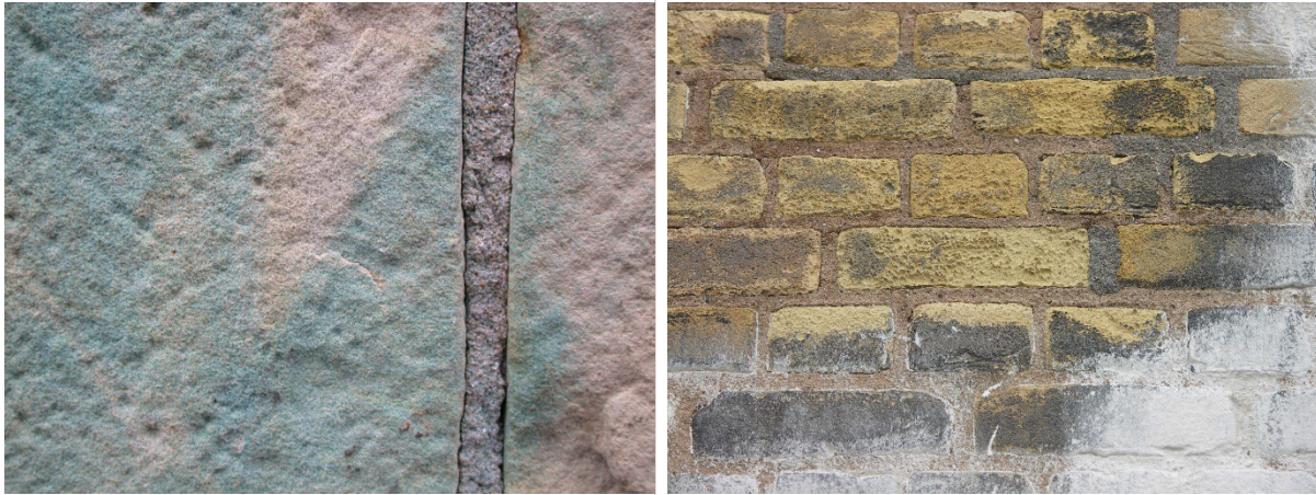
Figuur 8 links: zandsteen met ingedrongen verf en een beschadigd oppervlak; deze verf kan niet middels stralen worden verwijderd. Rechts: baksteen metselwerk dat door stralen te sterk is beschadigd. Verf verwijderen middels stralen is zeer riskant.
